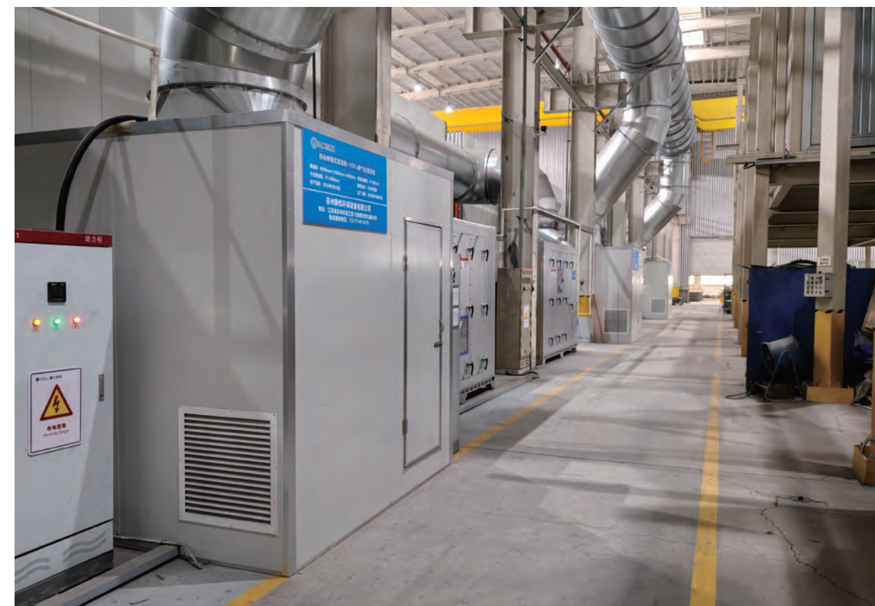
降噪控制设备：大型风机隔离室
