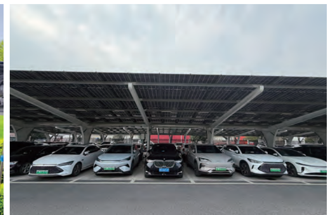
厂区新能源车辆充电桩
