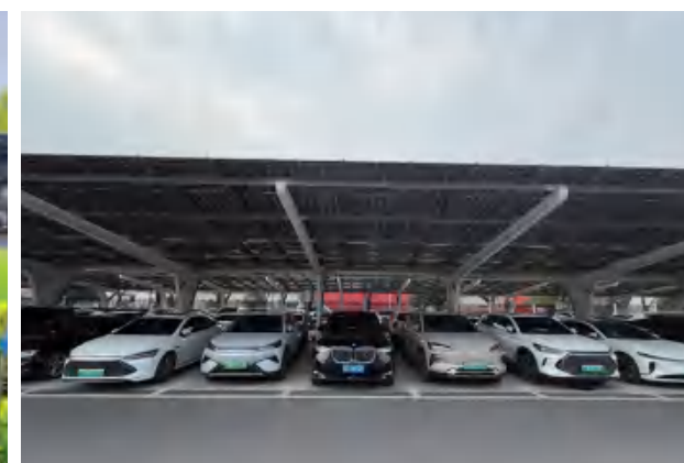
厂区新能源车辆充电桩
