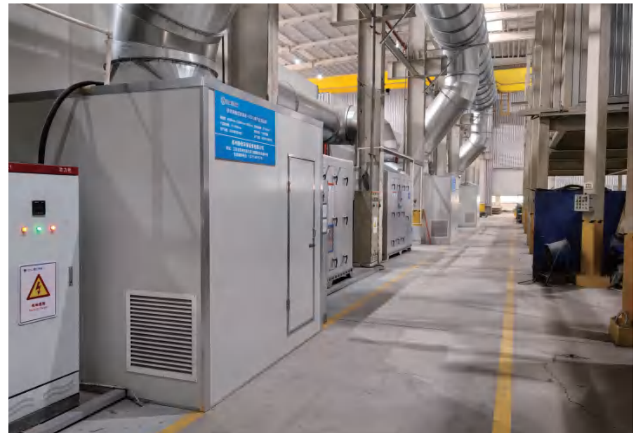
降噪控制设备: 大型风机隔离室
